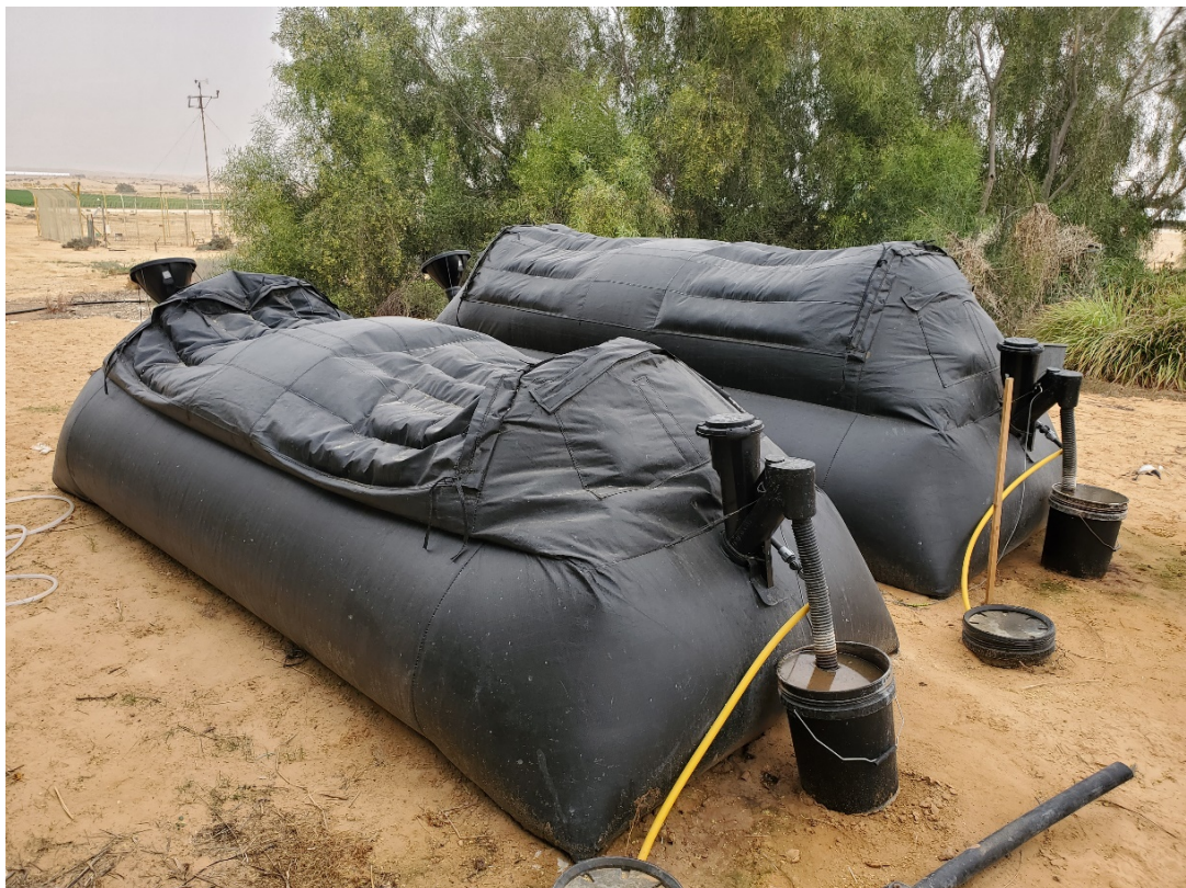
איור 1. שתי מערכות 7 Homebiogas שהותקנו במו"פ רמת הנגב
